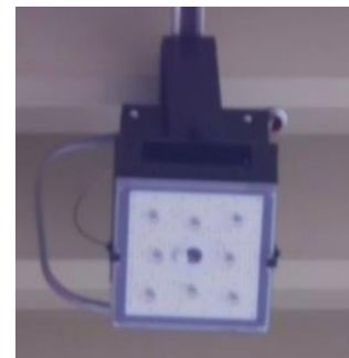
▲作業場LED照明
